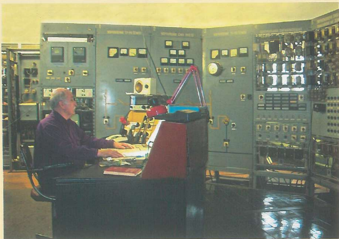
А.А. Тиунов за пультом управления подстанцией
